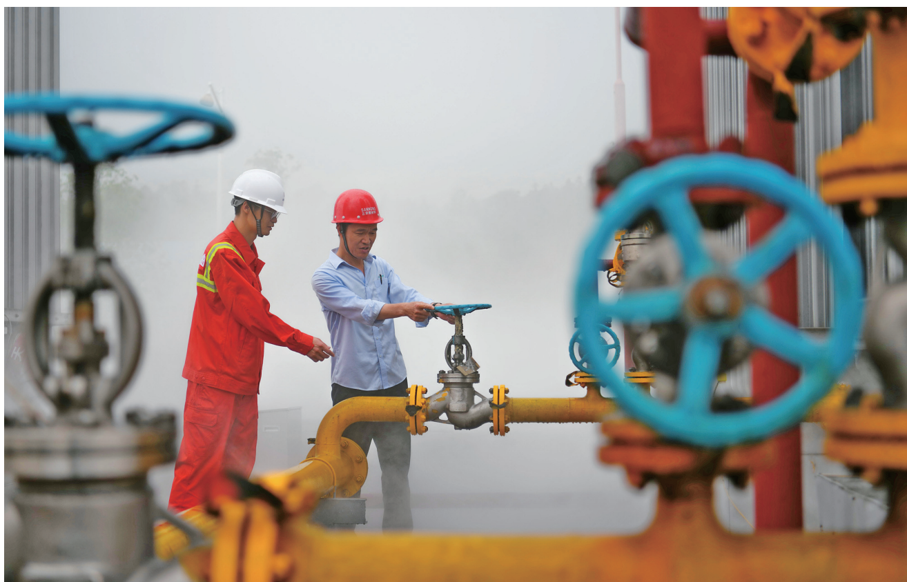
乐发灯(右一)检查制冷设备运行情况
