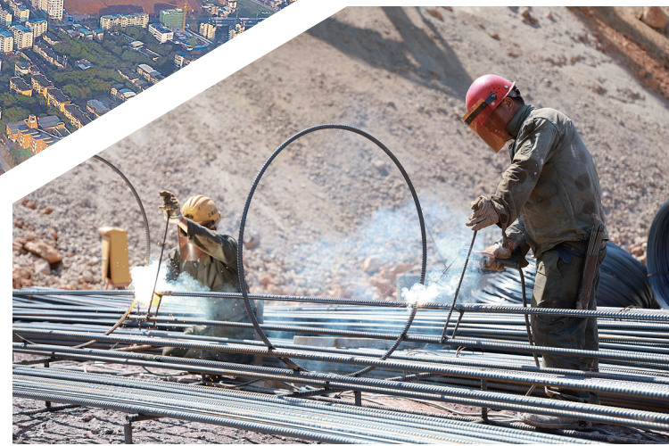
在永安市垃圾无害化项目建设现场工人正在焊接钢筋 (阙桂珍摄)
