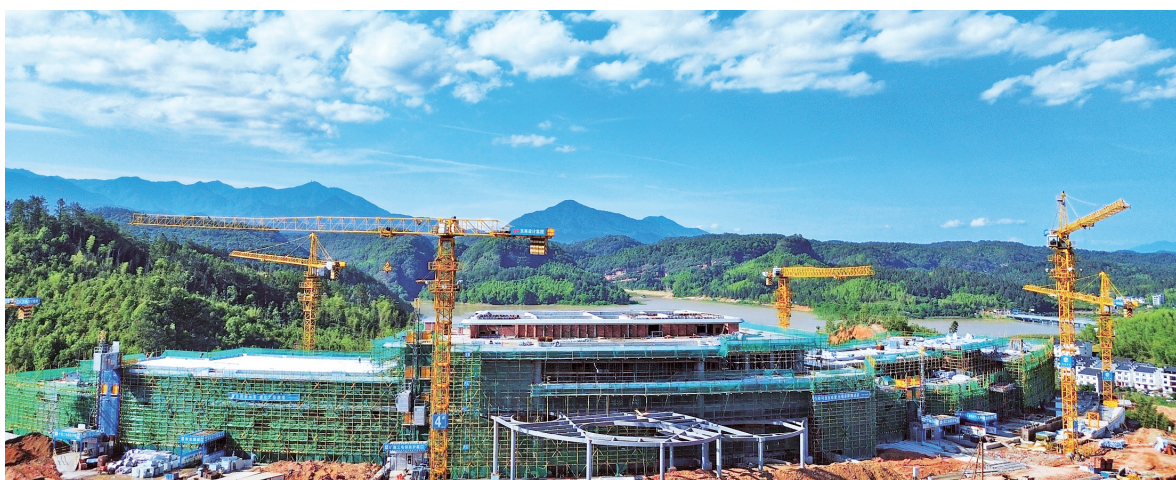
5月6日,泰宁锦江国际度假酒店项目建设热火朝天。(泰宁记者站 李少兰 熊明欢 摄影报道)
